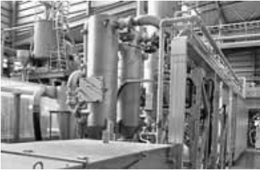
異物を徹底的に除去する（小山工場のメカニカルリサイクル設備）
