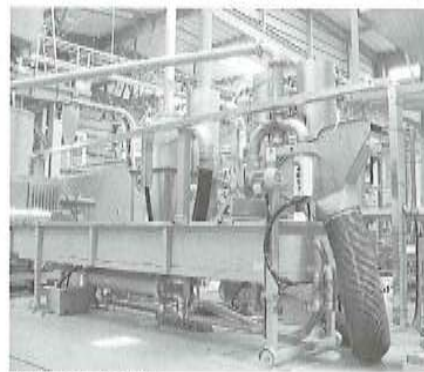
再縮合重合設備
